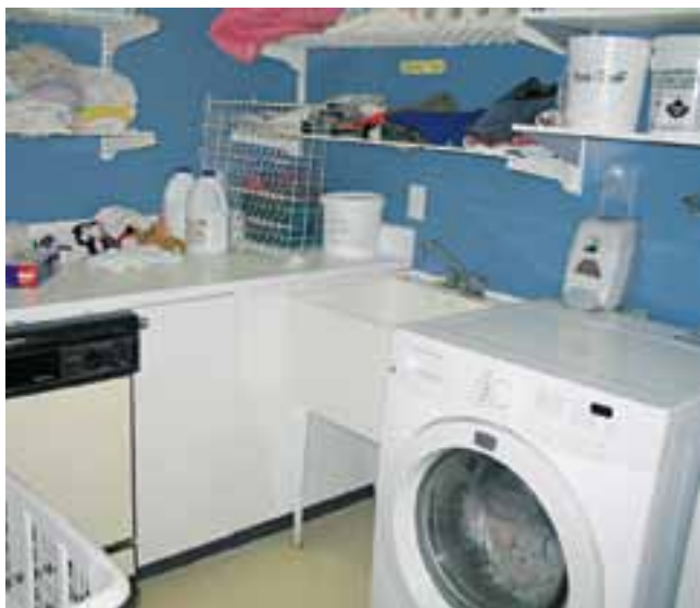
La ventilation doit permettre d'évacuer l'humidité créée par le lave-vaisselle et la laveuse.
