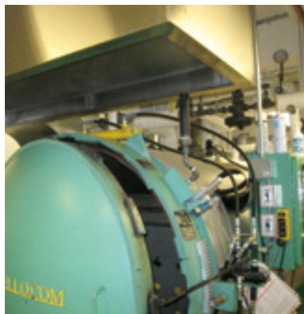
Ventilation au-dessus de l'autoclave.
