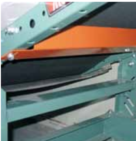
5. Corrections apportées : recouvrir d'un garde chaque rouleau d'entraînement sous le convoyeur et sécuriser l'angle rentrant à la partie supérieure du convoyeur.
