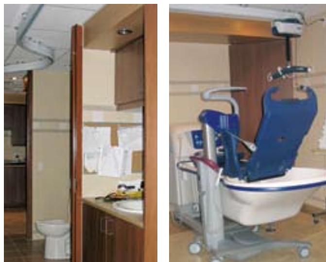
L'espace sanitaire comprend trois pièces : une salle de douche avec civière-douche ou chaise de douche ; une salle de bain avec baignoire ajustable en hauteur ; au centre, une salle de toilettes, avec un lève-personne sur rail au plafond (LPSRP) qui permet les déplacements dans les trois pièces.
