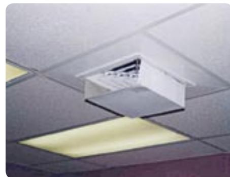
2. L'obstruction d'un diffuseur d'air frais est indicateur de la présence de courant d'air désagréable pour les occupants (photo : Michel Legris).
